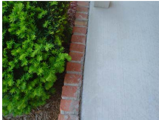
Porch edge cracked
